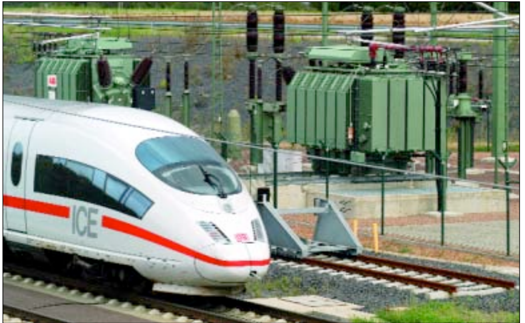
Weil sich die Energiepreise verteuern, will die Bahn die Preise für die Tickets anheben. Einen Teil ihres Strombedarfs produziert die Bahn selbst. Unser Bild zeigt das Umspannwerk bei Limburg.
